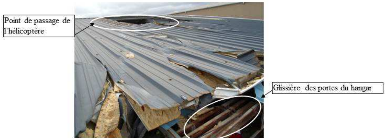
Vue du toit du hangar et détail de la glissière des portes
